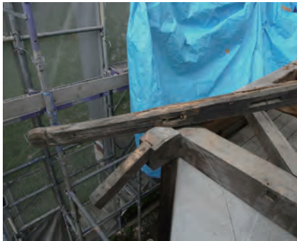
解体時 隅木 材の一部は腐朽が進行していました
