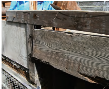
解体時 大梁 当初材であり、蟻害が著しかった
