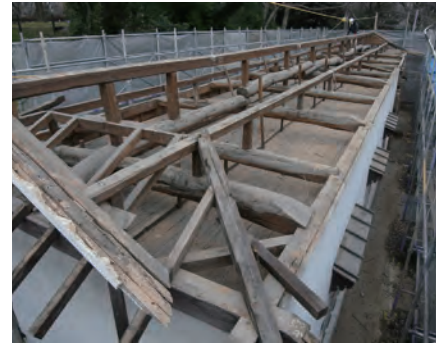
解体時 小屋組み 棟木・母屋の水平が取れていません
