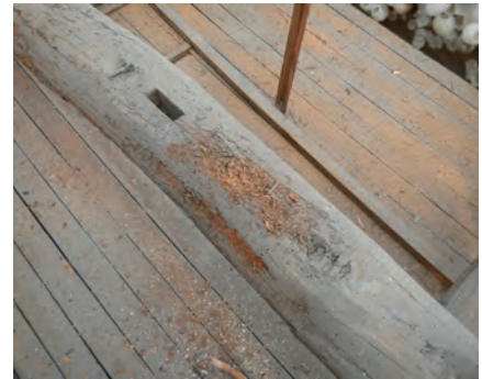
解体時 牛梁 小屋組みにも蟻害が及んでいました
