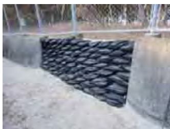
擁壁毀損部分現況
